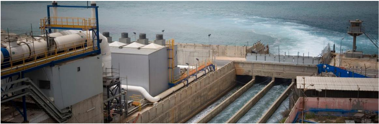
Een ontziltingsinstallatie in Haifa in Israël
